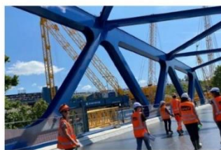
Les futurs ponts, peints en bleu roi, ont été soudés sur place et attendent d'être déplacés par la grue.
