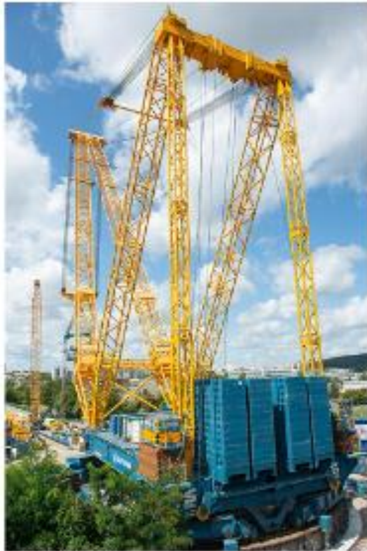
Le GTC 90 assemble Little Coléole. Son poids total de 4 400 t – dont 2 700 de contrepoids – est réparti sur une flèche de 100 m de longueur. – © Philippe Dumas pour l'Inra/3023
