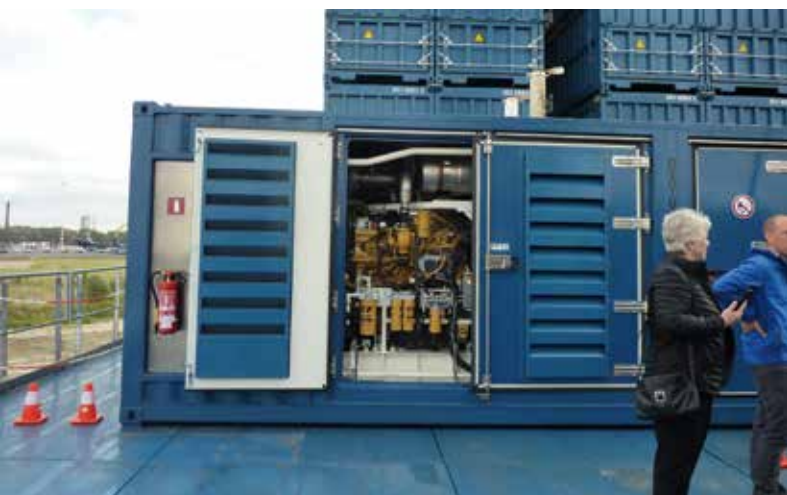
Auf dem Oberwagen finden sich neben der Krankabine auch insgesamt sechs Power Pack Units (PPU). Jede PPU besteht aus zwei 260 kW Caterpillar-Motoren.
